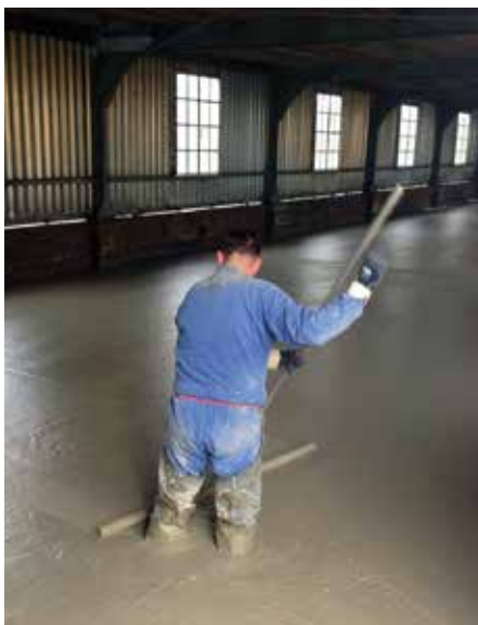
Schuimbeton, waarop later een 10 cm zandpakket, waarin de leidingen worden opgenomen. De oude klinkers worden vervolgens teruggelegd.
